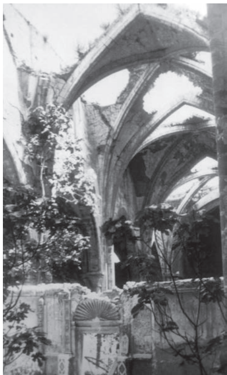
Fig. 9. La chiesa, lo stato di degrado con le volte crollate e l'abbandono prima degli anni Settanta (da IBARGUEN SOLER 2003, p. 105).
