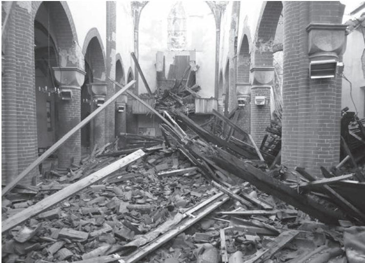
Fig. 4. L'interno dopo il sisma ed il crollo completo delle coperture e delle volte della navata centrale.
