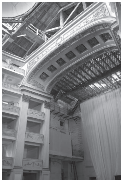
Fig. 1. Vista della copertura prima del restauro, da cui si scorge la cupola apribile realizzata negli anni Trenta.
