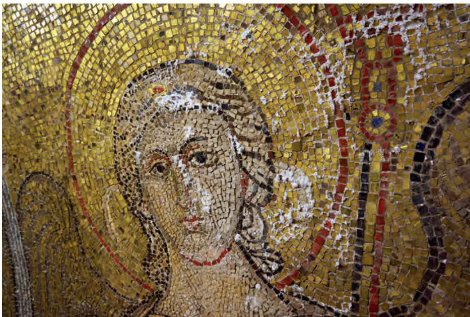
Fig. 4. Efflorescenze saline, costituite essenzialmente da cloruro sodico, presenti su un mosaico parietale della basilica.
