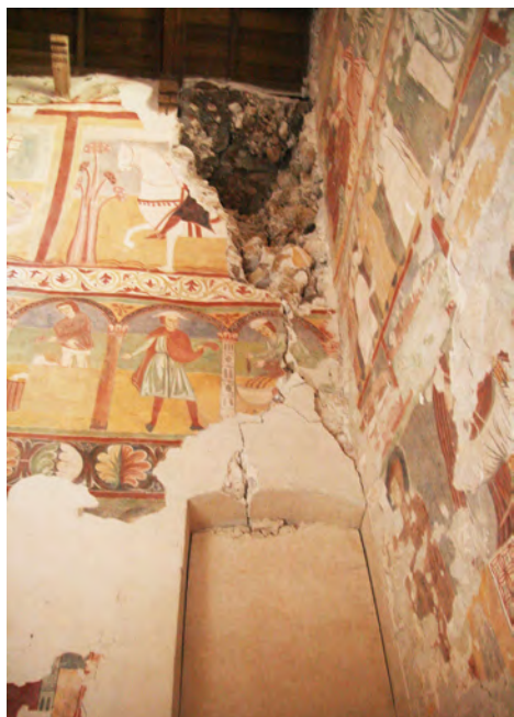
Fig. 2. Il crollo del paramento interno presso l'angolo ovest.
