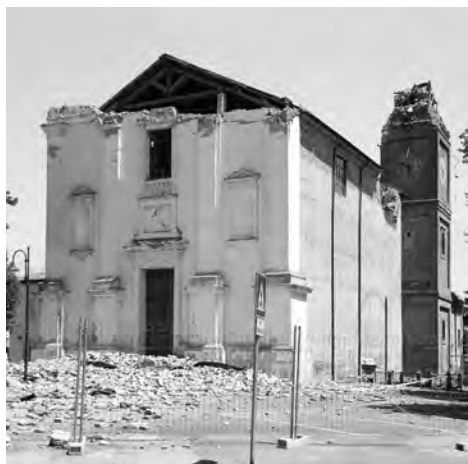
Fig. 6. San Possidonio (Modena), chiesa di S. Possidonio: perdita del frontone e di parte della copertura; crollo parziale della torre campanaria e fortissime lesioni concentrate prevalentemente nella porzione absidale. Si tratta di danni che, sebbene molto gravi, possono essere risolti attraverso una consapevole traduzione dei principi conservativi.
