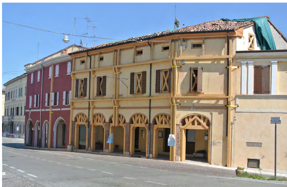
Fig. 1. Quistello, centro storico; opere provvisorie per contrastare i cinematismi di ribaltamento delle facciate, la caduta di elementi del cornicione e puntellare le arcate del portico.
