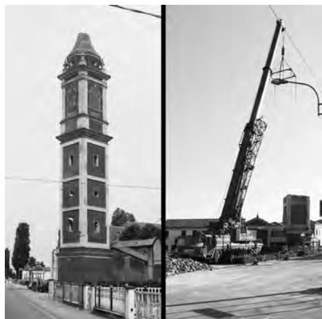
Fig. 3. Buonacompria di Cento (Ferrara), Torre campanaria. Irrimediabilmente lesionata, la torre è stata smontata per grandi 'blocchi murari', il cui riutilizzo appare enormemente problematico.
