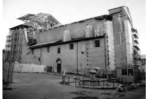
Fig. 3. Veduta della chiesa durante i lavori per la realizzazione della copertura provvisoria (febbraio 2011).
