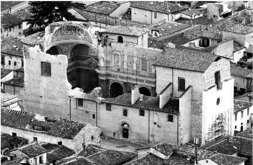
Fig. 1. Foto aerea dopo il sisma, in cui è evidente la parte crollata (aprile 2009).
