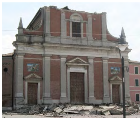
Fig. 3. Un dettaglio del lato meridionale dell'edificio che mette in evidenza il meccanismo di danno determinato dal ribaltamento della facciata.
