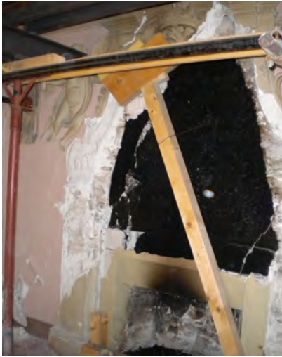
Fig. 2. Crollo di una porzione di parete trasversale con la caduta degli stucchi decorativi del camino (maggio 2011).
