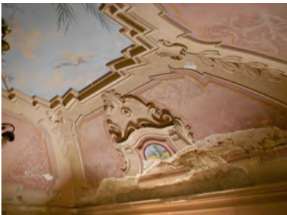
Fig. 3. Volte lesionate e con porzioni distaccate di stucchi e d'intonaco dipinto a tempera (maggio 2011).
