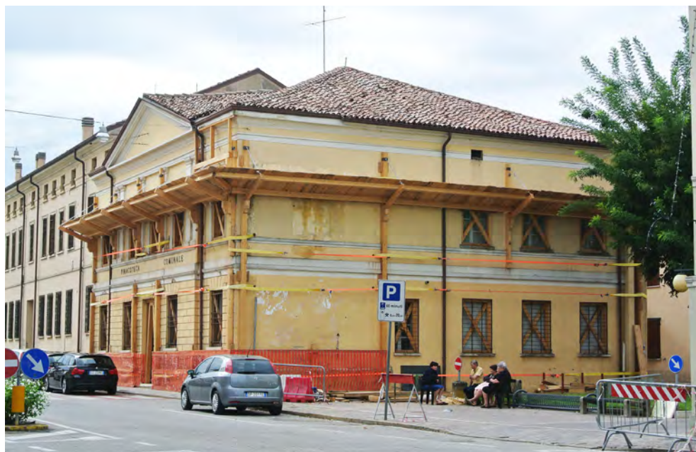
Fig. 7. Quistello, Pinacoteca; messa in sicurezza dell'edificio mediante cerchiatura disposta su più livelli e realizzazione di "mantovana" a protezione del passaggio di persone nella strada pubblica sottostante.
