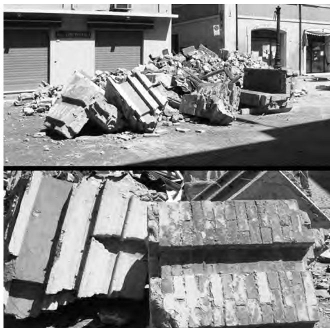
Fig. 5. Finale Emilia (Modena), Torricino del Palazzo Comunale. I brani murari rovinati al suolo sono rimasti parzialmente integri in alcune parti, senza scomporsi irrimediabilmente. Pertanto sono stati giustamente accantonati, sebbene ci sia ampia incertezza su un loro effettivo riutilizzo.
