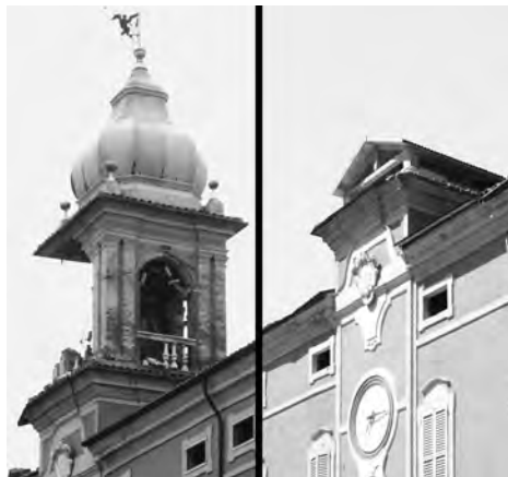
Fig. 2. Finale Emilia (Modena), Torricino del Palazzo Comunale. Simbolo della municipalità di Finale Emilia, l'edificio è stato gravemente danneggiato dalla prima scossa ed è poi definitivamente rovinato al suolo a causa della seconda.
