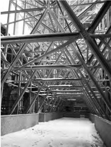
Fig. 2. Particolare dell'interno della chiesa allo stato attuale, dopo una nevicata (febbraio 2012); si può osservare la scarsa tenuta dei teli protettivi.
