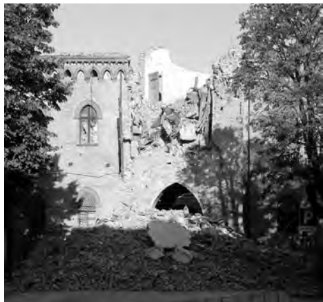
Fig. 1. Poggio Renatico (Ferrara), Maschio di Palazzo Lambertini. Si tratta di un crollo pressoché totale per il quale è stata già invocata una inattuabile ricostruzione à l'identique .
