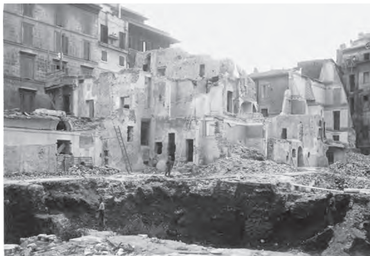
Fig. 2. Roma, l'isolato di origine medievale sito tra via di S. Nicola dei Cesarini e via di Torre Argentina durante la demolizione, nel 1926 (Archivio Soprintendenza Capitolina BB.CC.).
