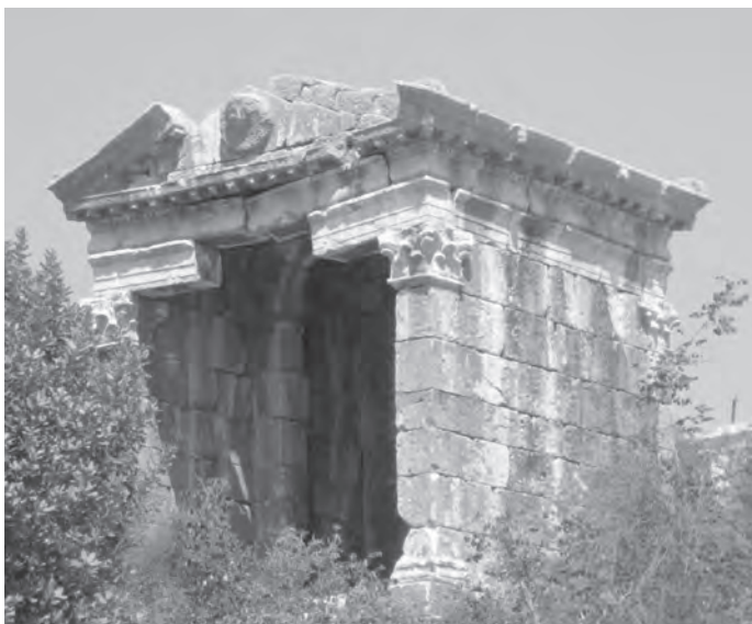
Fig. 2. Demircili, il monumento funerario 'a tempio' presenta evidenti patologie di degrado e chiari segni di dissesto statico.
