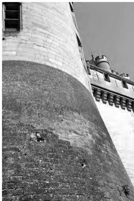
Fig. 4. Veduta di uno dei torrioni di Pierrefonds: è riconoscibile il basamento antico, sul quale Viollet completa la costruzione e in cui sono ancora conficcate le palle di cannone sparate per la demolizione del Castello (che Viollet non ha rimosso) (foto G. Guarisco, 1991).
