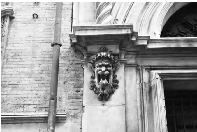
Fig. 7. Loggia dei Mercanti. Particolare della facciata. Sono evidenti il deposito superficiale e alcune croste nere in fase iniziale.
