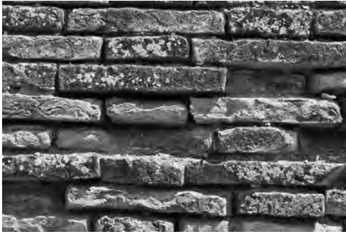
Fig. 5. Mura sangallesche. I mattoni del paramento murario appaiono in più punti polverizzati e mancanti.
