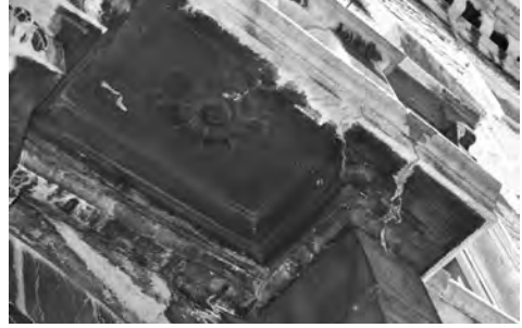
Fig. 3. Palazzo degli Anziani. Croste nere in corrispondenza dei lacunari del balcone del prospetto principale.
