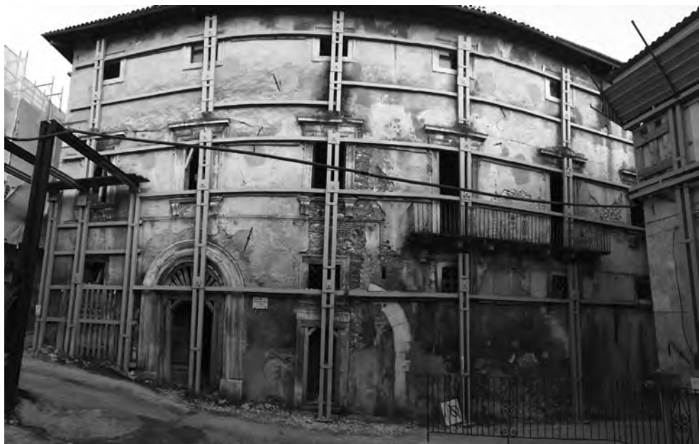
Fig. 5. Il palazzo Baroncelli-Cappa in via Paganica è uno degli edifici pubblici attualmente trascurati per la mancanza di prospettive di utilizzo. I segni delle complesse vicende costruttive, la persistenza nel cortile cinquecentesco di elementi settecenteschi altrove emendati, lo spazio antistante (unico largo sul fitto tessuto urbano) confermano un interesse che va ben oltre gli apparati decorativi interni (2022).
