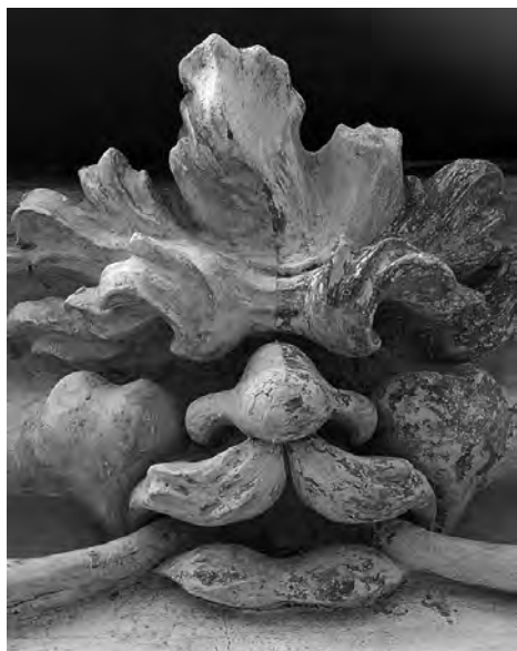
Fig. 4. Palazzo Doria Pamphilj, prospetto su via del Corso: mascherone del cornicione superiore. Si notano le tracce del colore scuro applicato nell'intervento di Andrea Busiri Vici e della soprastante tinteggiatura vinilica chiara applicata nel 1990. Foto S. Sarmati, su gentile concessione Trust Doria Pamphilj.
