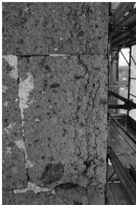
Fig. 7. Degrado del bugnato angolare. Si evidenziano lesioni legate alla compressione e gravi e diffusi fenomeni di esfoliazione.
