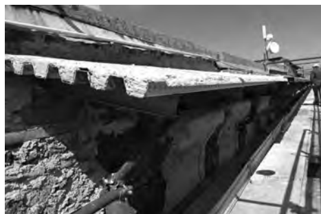
Fig. 1. Valmontone, palazzo Pamphilj, ricostruzione della parte terminale del cornicione: realizzazione della struttura attraverso travi in ferro e lamiera grecata.
