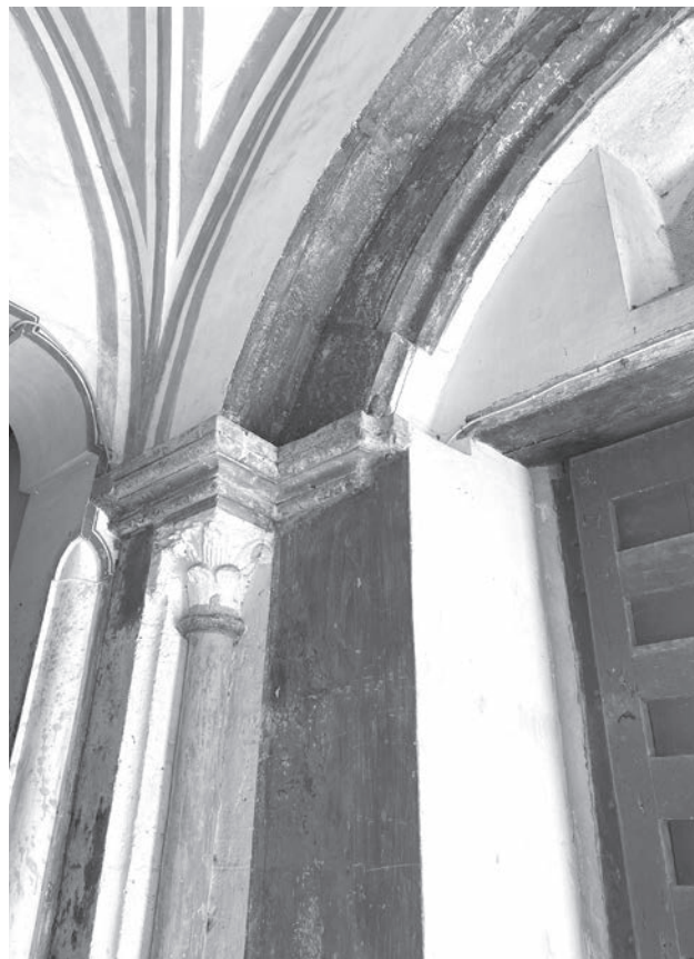
Fig. 18 – San Marco Argentano, abbazia di Santa Maria della Matina, dettaglio del portale d'accesso al chiostro che presenta tracce del cambiamento della sezione degli archivolti (foto dell'autore).
