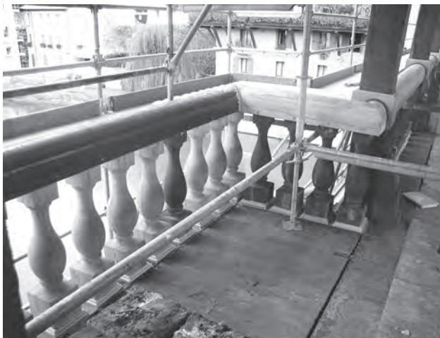
Fig. 7 – Bassano, Ponte Vecchio, restauri del 2005, ampie sostituzioni in uno dei poggioli (foto Comune di Bassano del Grappa).
