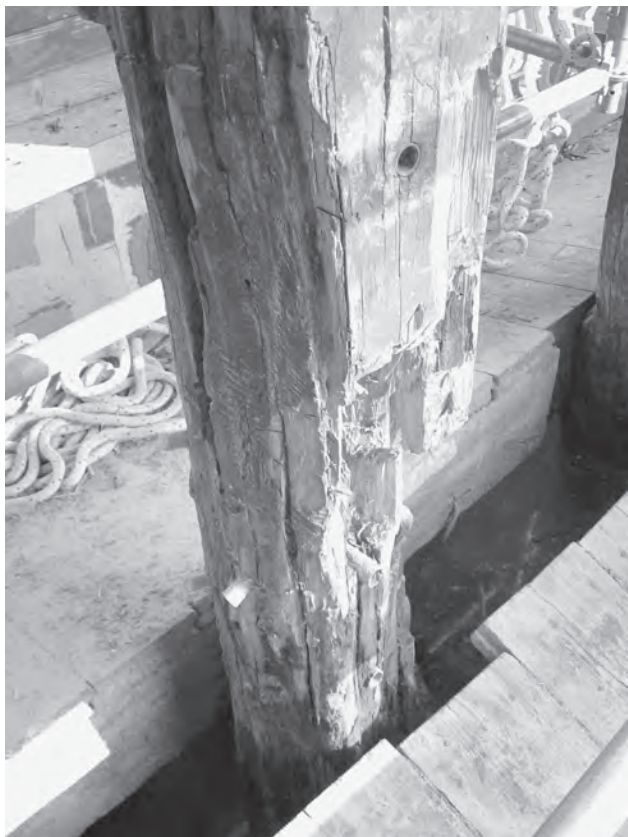
Fig. 6 – Bassano, Ponte Vecchio, danni ai legni restaurati solo pochi anni prima, rilevati nel corso dei lavori del 2005 (foto Comune di Bassano del Grappa).
