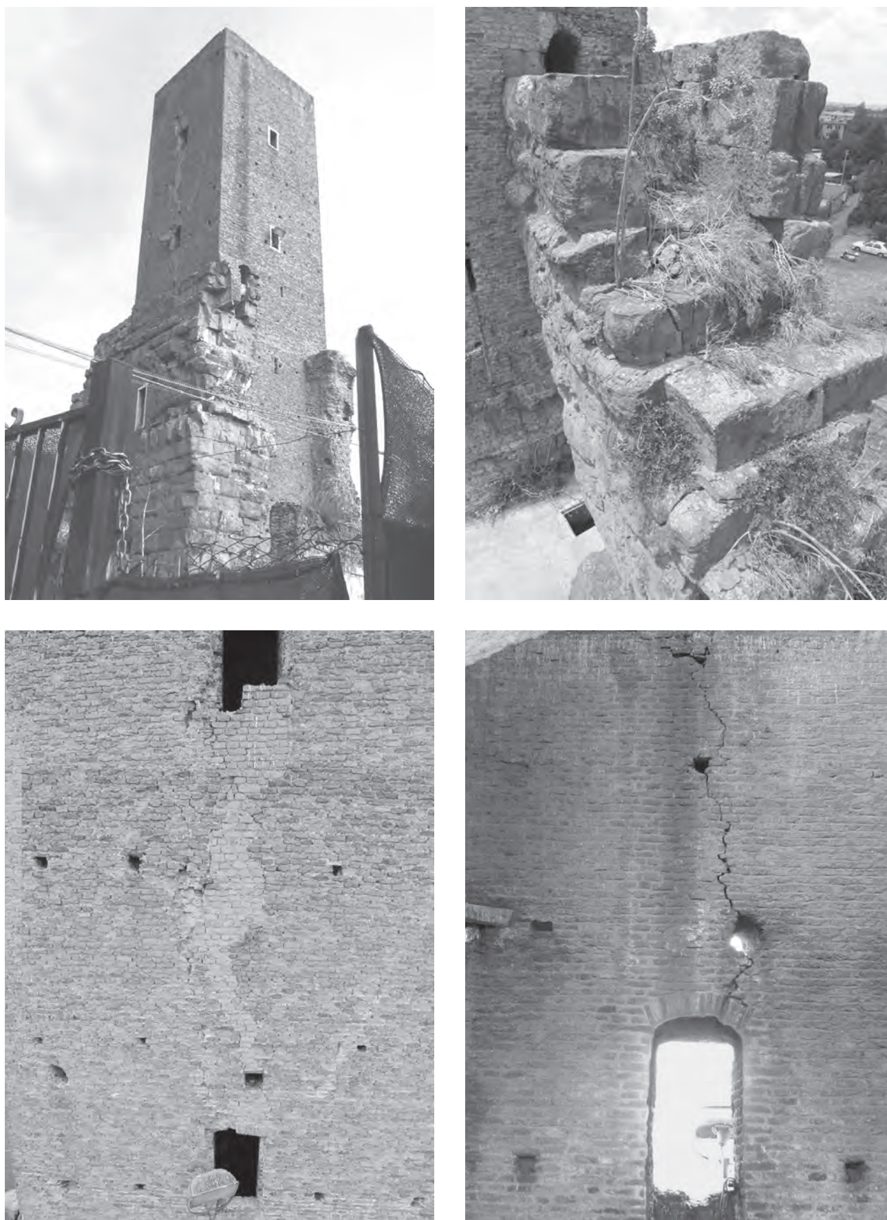
Fig. 6 – Roma, Torre del Fiscale, in alto: a sinistra, un'immagine della torre prima degli interventi con i vistosi segni di degrado della muratura a blocchi, specialmente nello spigolo in primo piano; a destra, la porzione di arcata esterna alla torre con il pilastro, anch'esso in condizione di grave degrado soprattutto per l'effetto invasivo di diverse specie vegetali. In basso: a sinistra un dettaglio della facciata esposta a nord che mostra l'esito del precedente restauro (reintegrazione tufelli più rossicci, solo all'esterno) e la lesione riapertasi prima del Duemila; a destra una vista interna, sul paramento opposto, che evidenzia la stessa lesione passante che non ha subito il risarcimento degli anni Ottanta (foto dell'autore).
