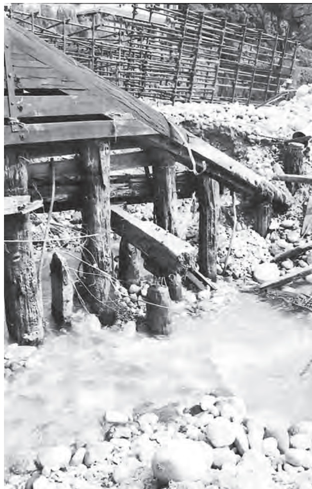
Fig. 5 – Bassano, Ponte Vecchio, danni alla seconda stila, rilevati nel corso dei lavori del 1990-92 (foto Comune di Bassano del Grappa).
