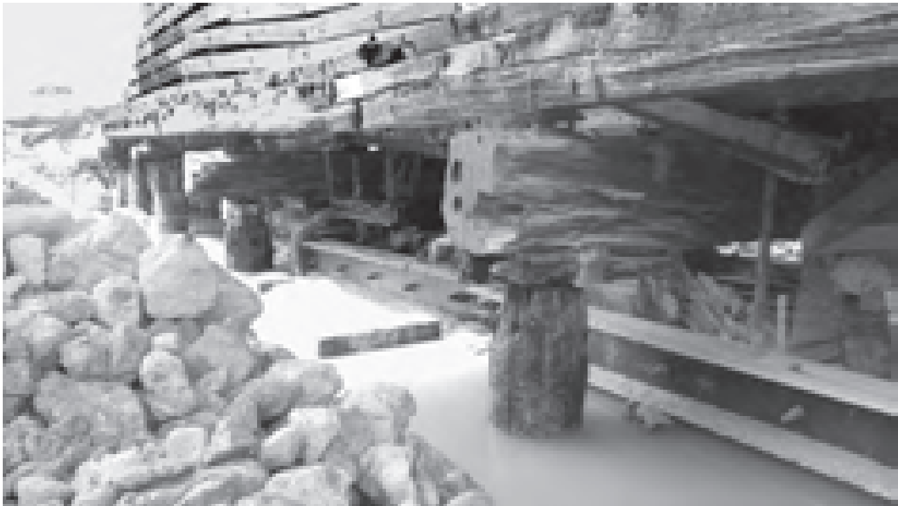
Fig. 12 – Bassano, Ponte Vecchio, situazione di degrado del sistema fondale e compresenza di materiali diversi: legno, acciaio, calcestruzzo armato, 2017 (foto Comune di Bassano del Grappa).
