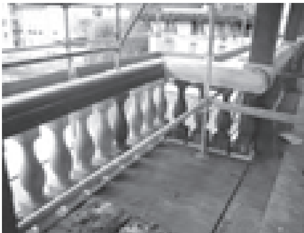
Fig. 7 – Bassano, Ponte Vecchio, restauri del 2005, ampie sostituzioni in uno dei poggiali (foto Comune di Bassano del Grappa).
