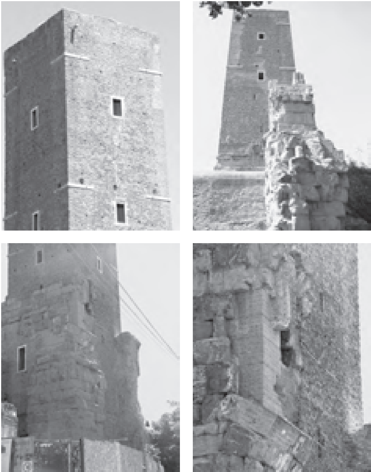
Fig. 10 – Roma, Torre del Fiscale, alcune immagini successive agli interventi: in alto, la torre con i capochiave angolari e i risarcimenti murari della cortina in tufelli (degli anni Ottanta) con le integrazioni e il recente consolidamento con iniezioni e stuccature dei giunti; a destra, in primo piano i resti del pilone del Claudio adiacente alla torre (con lesioni e aperture tra i blocchi) che è stato consolidato con risarcimenti e tiranti metallici reversibili; in basso lo spigolo più critico con gli interventi di ricostruzione ideale dei blocchi mancanti che restituiscono continuità alla muratura degradata dell'arcata e ricompongono lo spigolo dove fuoriesce lo speco (N-O); quest'ultimo è raffigurato a destra in una vista ravvicinata. Le ricostruzioni sono state realizzate con una cortina formata da una trama di blocchetti ordinari di peperino, spaccati, e maggiormente distanziati ove opportuno per delineare le geometrie dei blocchi originali. Il riempimento è realizzato con un conglomerato di calce idraulica e scaglie di peperino. Il blocco inclinato in primo piano nasconde il capochiave metallico del tirante che trattiene la spinta dell'arco dell'acquedotto Claudio non più bilanciata da quelle delle arcate esterne alla torre, ormai perdute (foto dell'autore).
