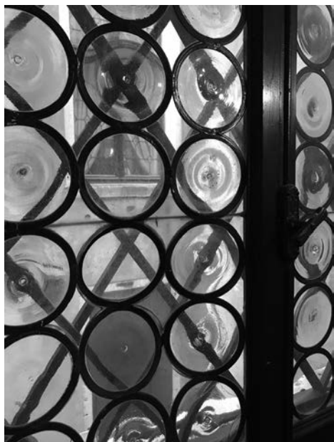
Fig. 7. Venezia, Palazzo Fortuny, dettaglio di un serramento ottocentesco formato da vetrata di fattura preindustriale legata con elementi di piombo. A causa delle istanze di efficientamento energetico i serramenti sono una fra le componenti più sostituite.
