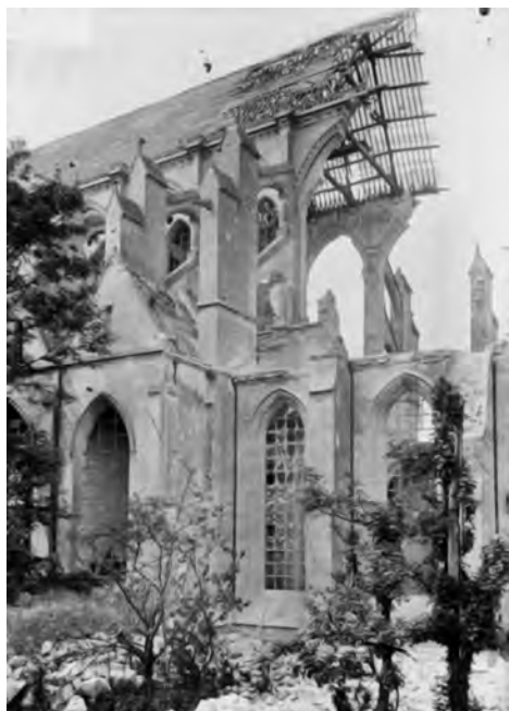
Fig. 5. The damaged roof of Soissons Cathedral ( https://www.pop.culture.gouv.fr/ ; reference sap01_mh0024001 © Ministère de la Culture, Médiathèque du Patrimoine et de la Photographie, diffusion RMN-GP).
