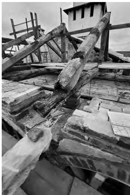
Fig. 3. Degrado dei nodi lignei delle orditure principali (2021).
